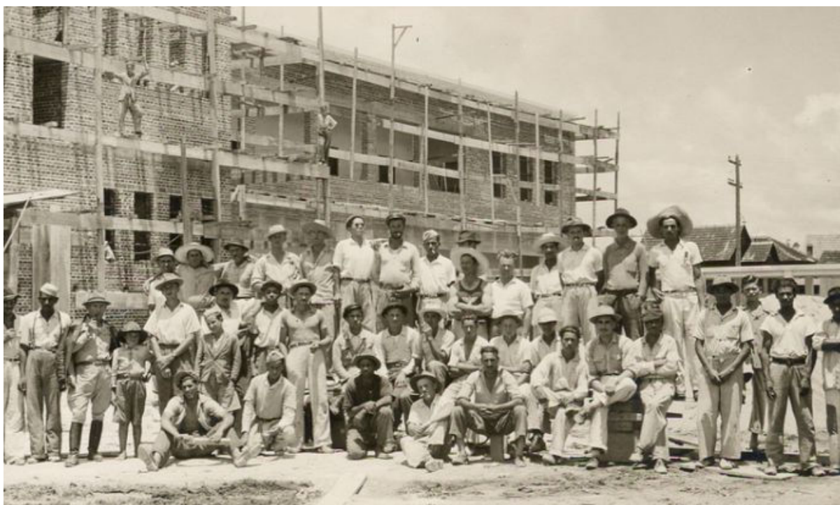
FIGURA 1 - VISTA PARCIAL DA CONSTRUÇÃO DA ESCOLA SENAI-PR – LOCALIZADO NA RUA CHILE - CURITIBA - 1947
